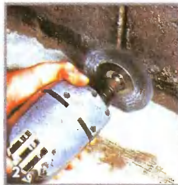
Вставив в дрель круглую металлическую щетку, зачистите места, где будут устанавливаться дренажные плитусы
