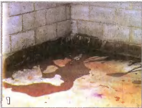
Лужи воды на полу подвала означают, что она просачивается по трещинам в полу и в стенах. Из-за этого подвал нельзя использовать, да и продажа дома станет трудной задачей
